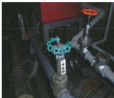
(写真1)バルブハンドル破損
