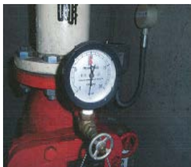
(写真2)泡消火設備圧力計故障
