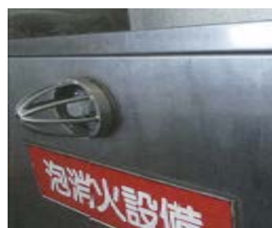
(写真3)泡消火設備表示灯破損
