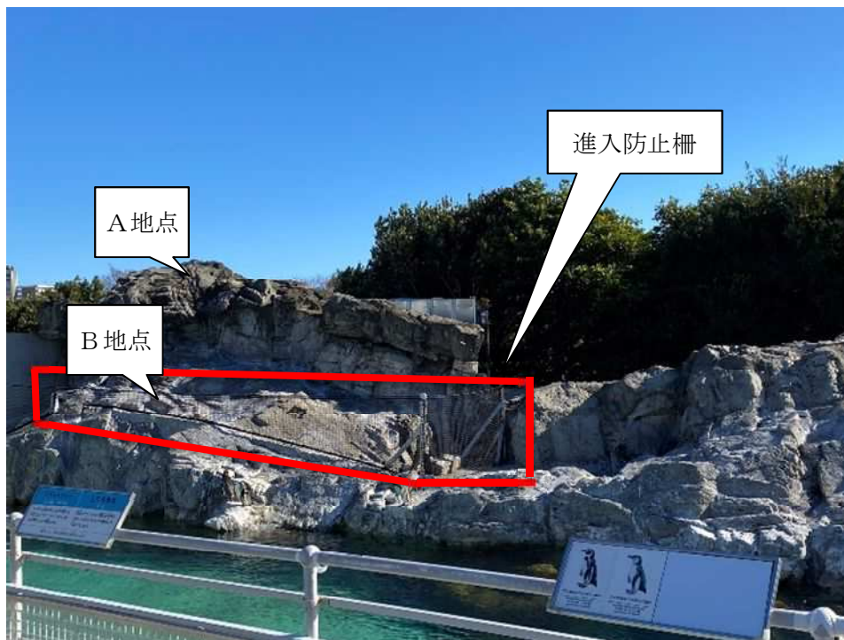
(写真2) ②工事によるペンギン等進入防止柵の設置状況
