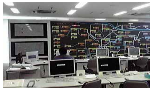
集中管理室による 運転監視の状況
