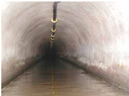
下水道管内の光ファイバーケーブル
