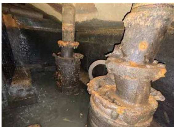
【図 3 排水ポンプ】
