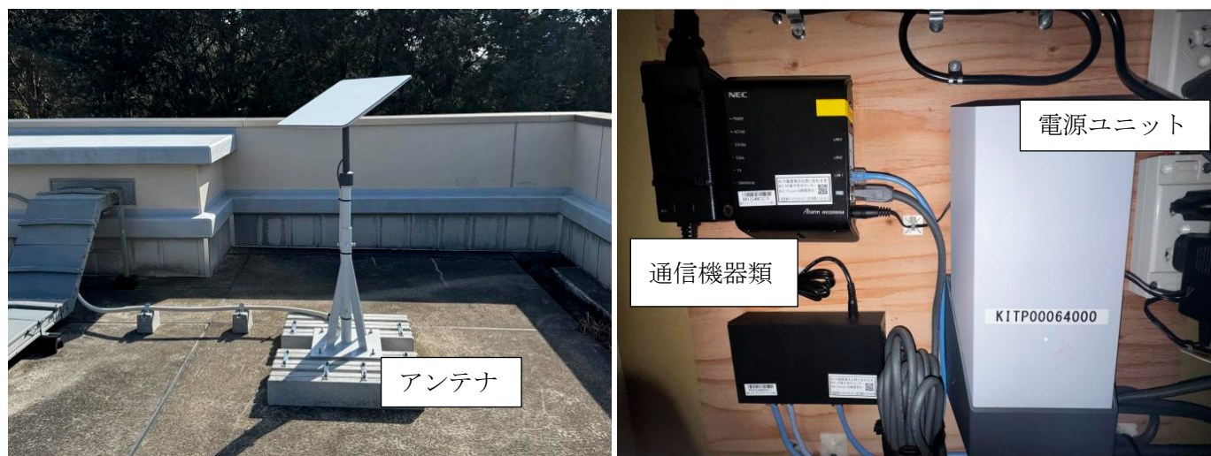
(図 5)OpenRoaming 対応 Wi-Fi 設備の例
